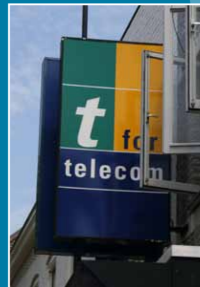
Te grote reclamebak op de 1 e verdieping
